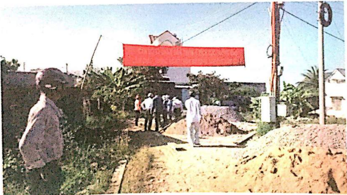
Cán bộ và nhân dân Thôn 1 tích cực hưởng ứng làm đường giao thông nông thôn
